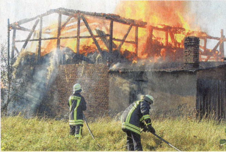
Eigentlich sollte das Dach der Scheune repariert werden. Aber beim Aufbringen der Pappe fing das Gebäude Feuer und brannte ab. FOTO: WEBER
